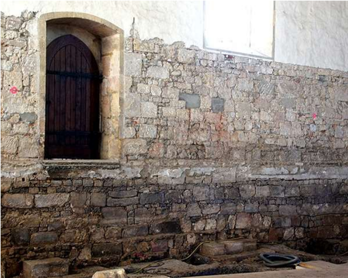
Nach Abnahme des Wandputzes an der Innenseite der Langhaussüdwand zeigt sich das heterogene Mauerwerk, das vor allem aus wiederverwendeten Bausteinen der abgebrochenen Vorgängerkirche besteht.
